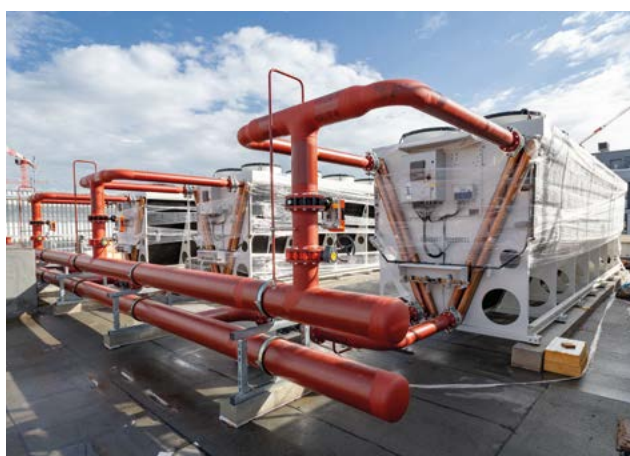
Groupe refroidisseur Photo David Mayenfisch / Urban Project SA
